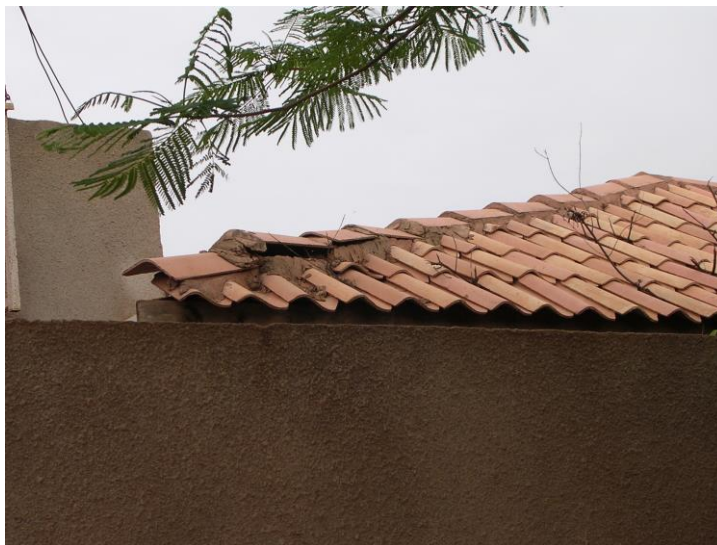
Photo 11 : Pose défailante de tuiles faîtière à Ouagadougou
