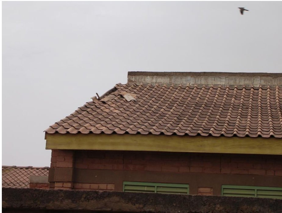
Photo 9 : Tuiles mal posées dans un quartier de Ouagadougou
