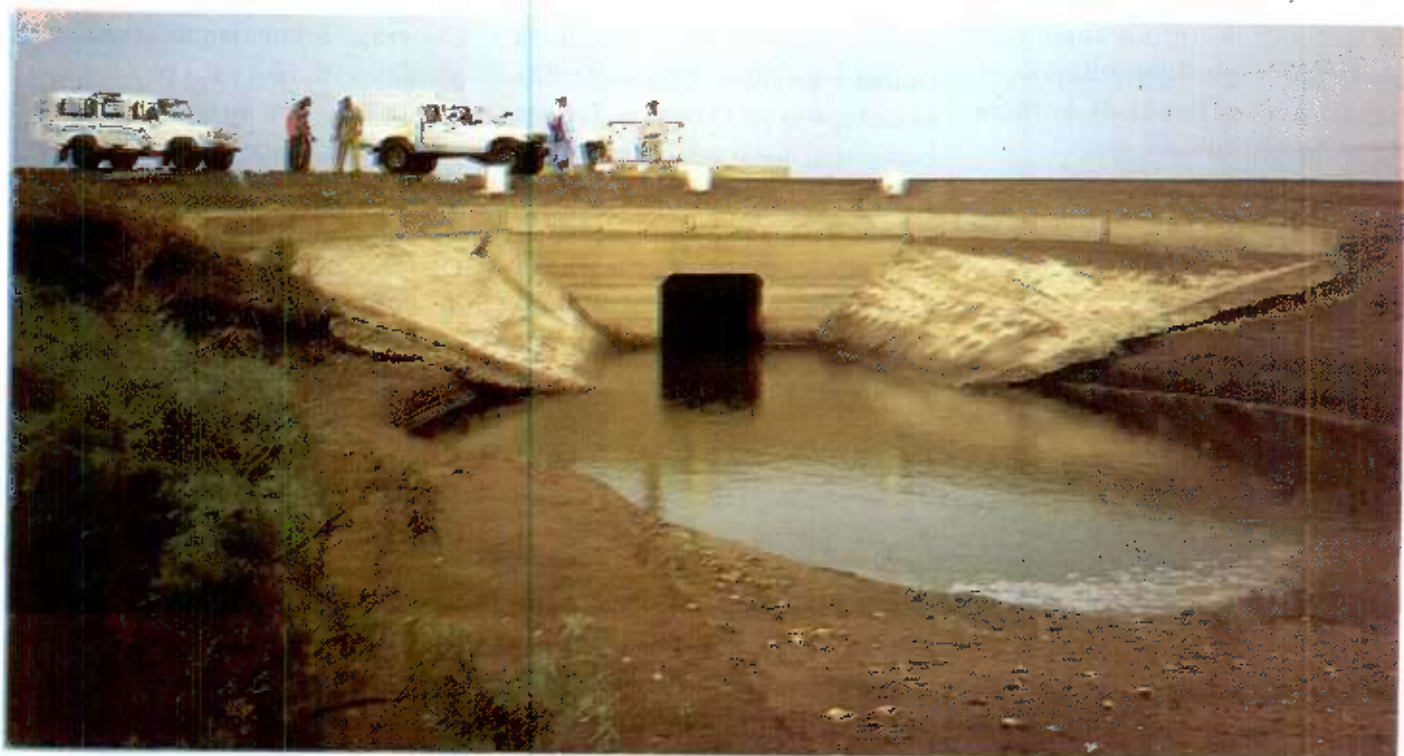
Photo n°3 : Ouvrage de Bell (O.M.V.S.) et cristaux en aval.
