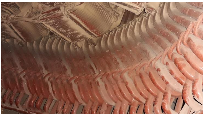
Figure 16: figure montrant l'état de salissure des enroulements
