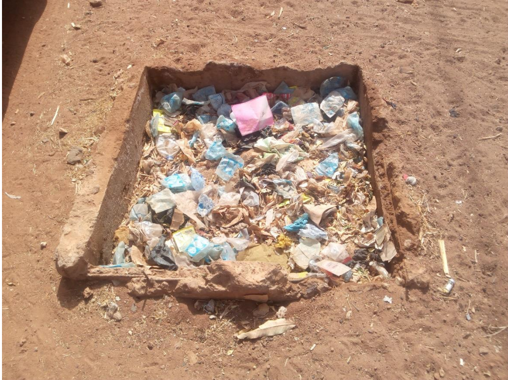
Figure 10 : Regard rempli de déchets
