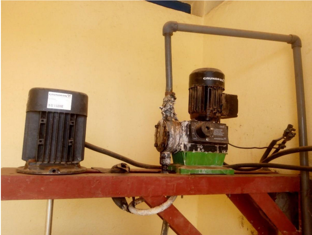
Figure 12 : Fuite au niveau de la pompe doseuse de chlore du refoulement distributif
