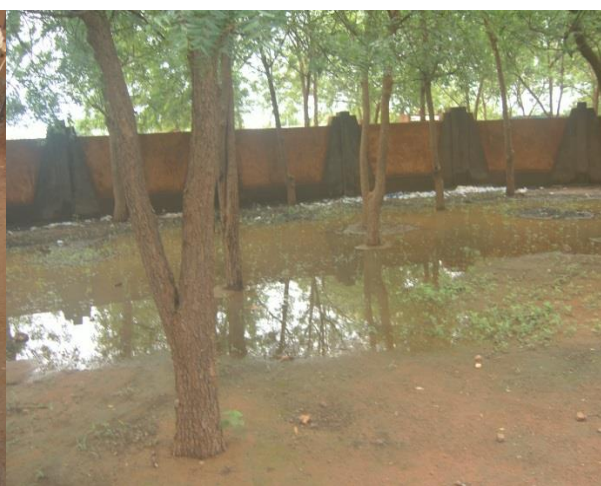
Stagnation d'eau due à un manque de drainage vers le trou de sortie du mur
