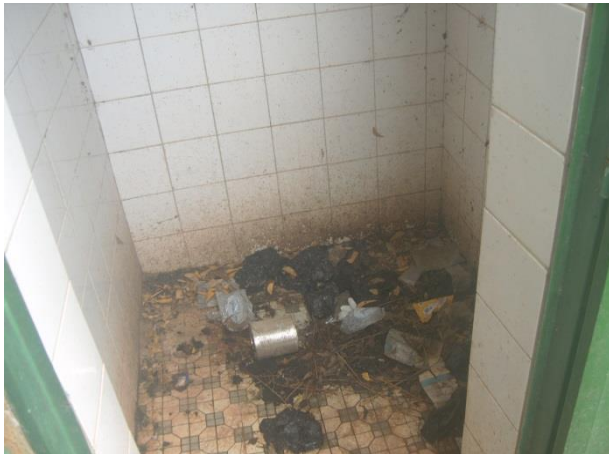
Latrine de la pédiatrie transformée en un dépotoir
