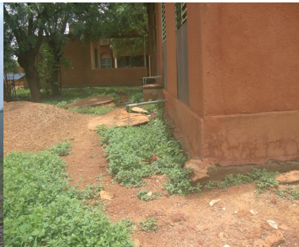
Fosse septique avec puisard pour les liquides biologiques de la maternité
