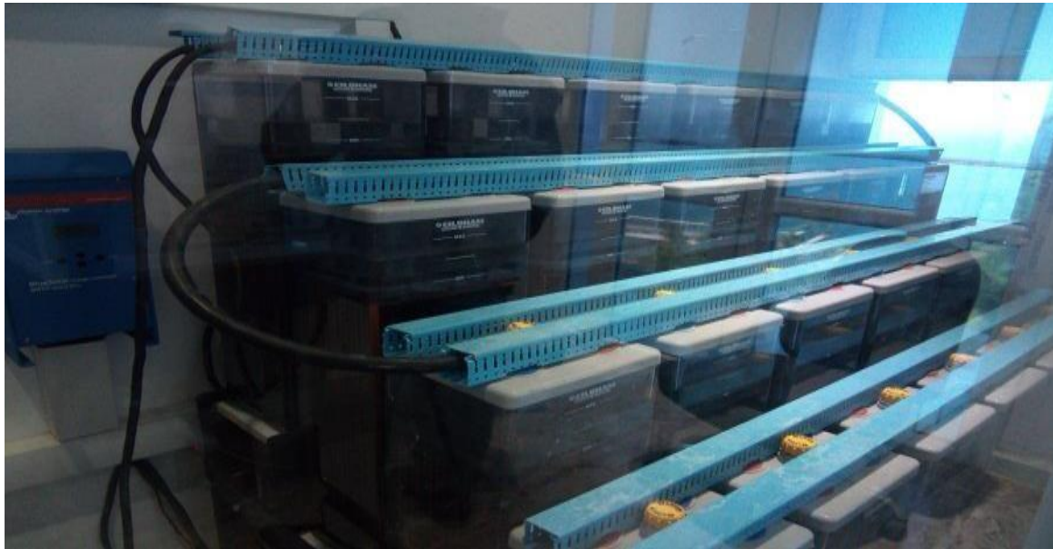
Figure 8 : banc de batteries pour un système PV autonome. [4]
