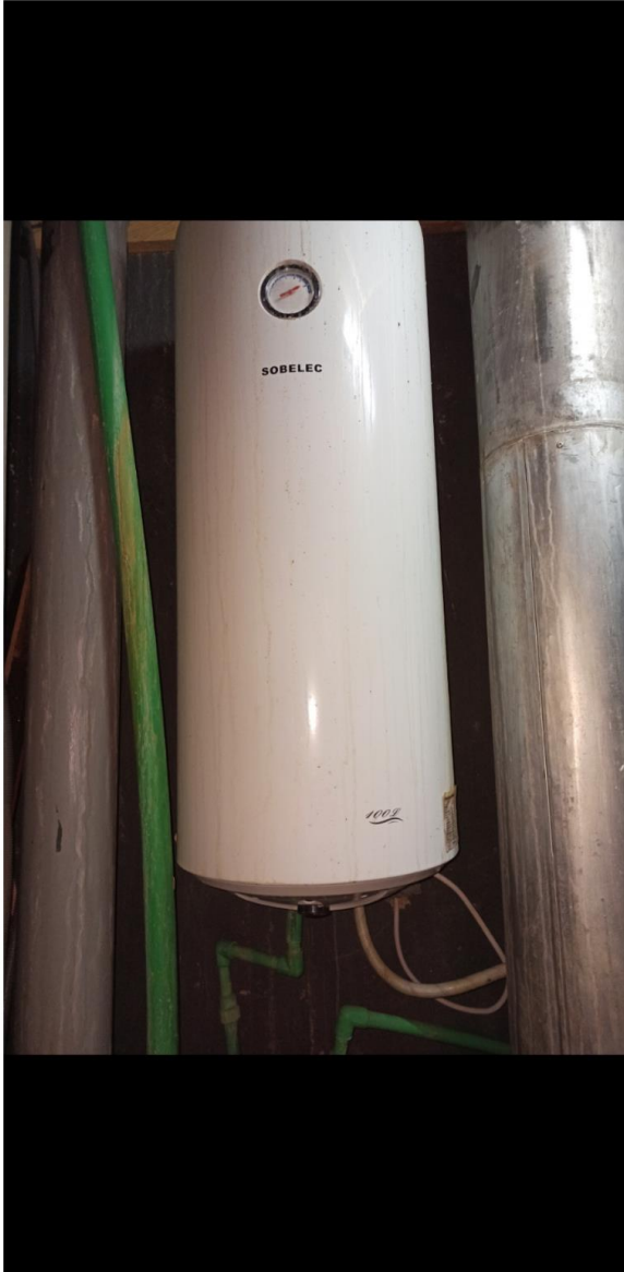
Annexe 12 : Chauffe-eau-électrique et allée principale des chambres
