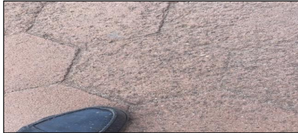
Figure 15 - Présence de lessivage ou perte de matière
