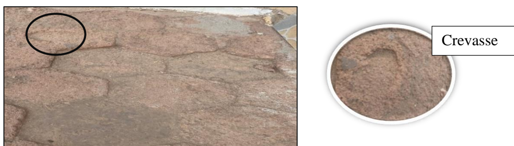
Figure 14 - Présence de crevasses
