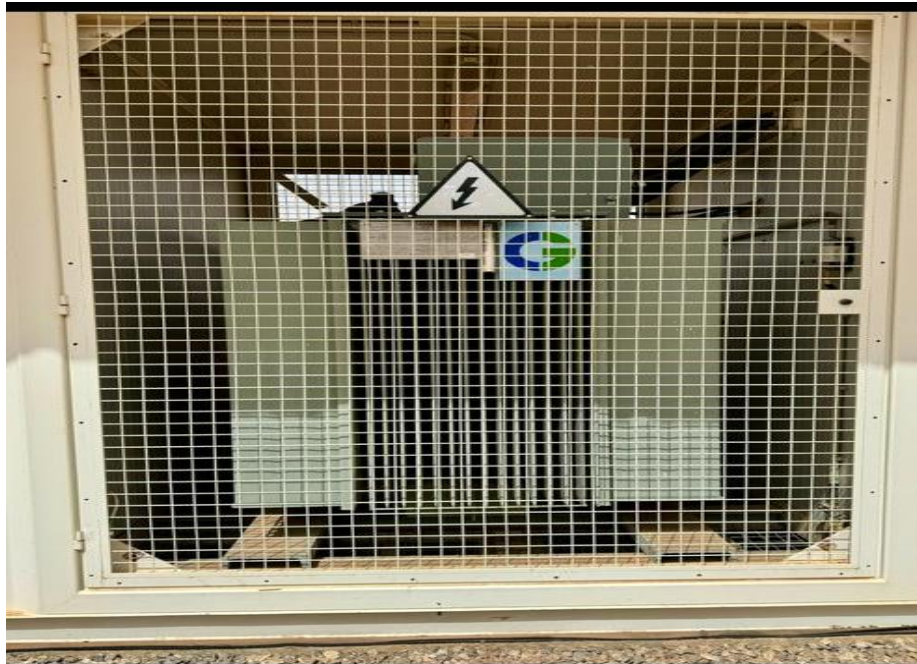
Figure 10 : Transformateur Pauwels 2,33 MVA dans son enclave grillagée
