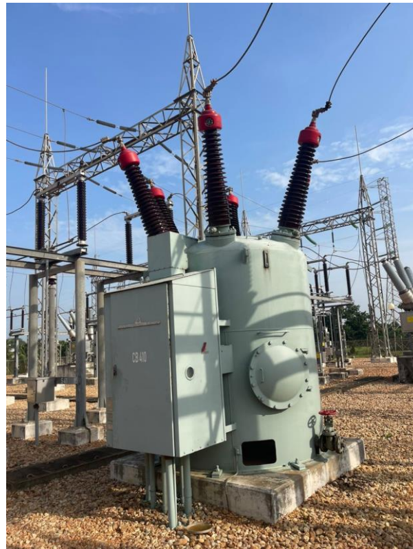
Figure 8 : Disjoncteur Pneumatique à gros volume d'huile
