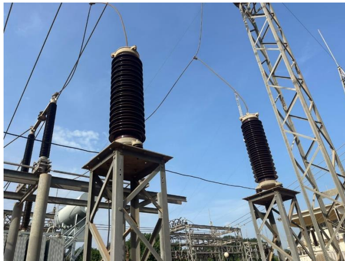
Figure 9 : Disjoncteur Live Tank
