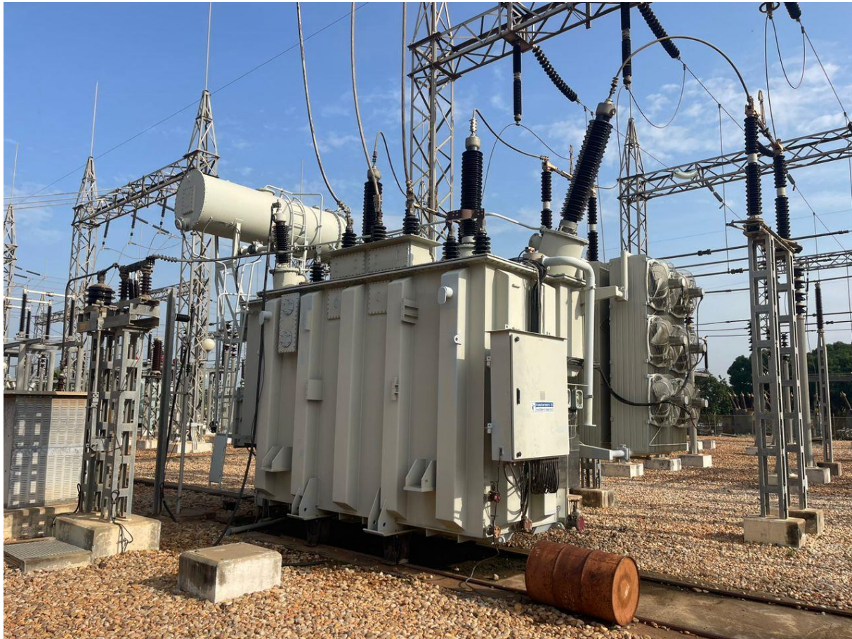
Figure 6 : transformateur du poste de Lomé Aflao
