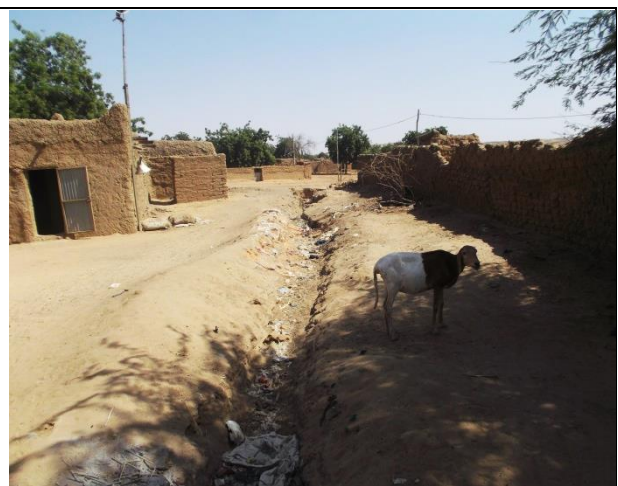
Photo 8 : Chenal d'évacuation des eaux d'inondation
