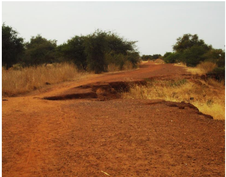
Photo 2 : Route départementale N°22 Yalgo-Nagbingou dégradée
