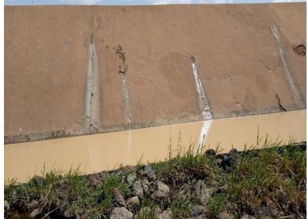
Image 4: Fissures sur le déversoir et fuites d'eau
