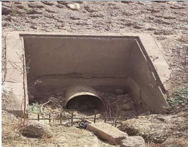
Image 6: Absence de grille amont et conduite partiellement bouché
