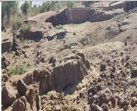
Image 10: Dégradation de la piste jusqu'au dalot submersible
