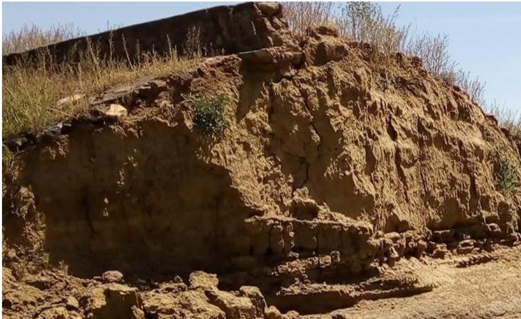
Image 13: Apparition de trous sous la digue
