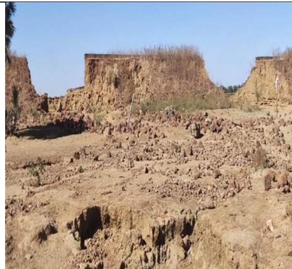
Image 2: Vue d'ensemble des deux brèches de la digue et de l'érosion aval
