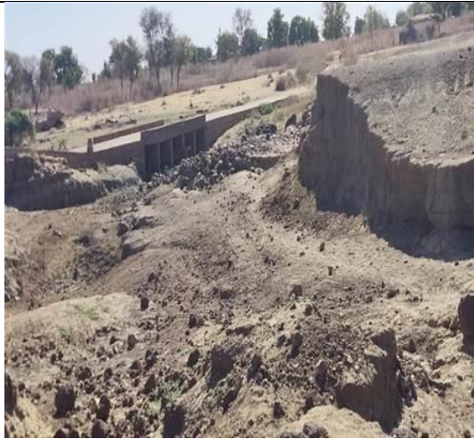
Image 8: Diguettes emportées par les eaux de crue
