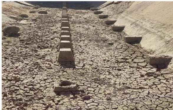
Image 5: Détérioration des blocs de chute et blocs chicanes
