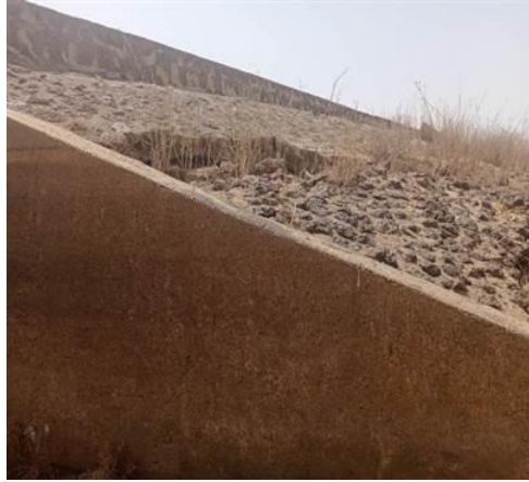
Image 3: Affaissement du perré maçonné sur le déversoir
